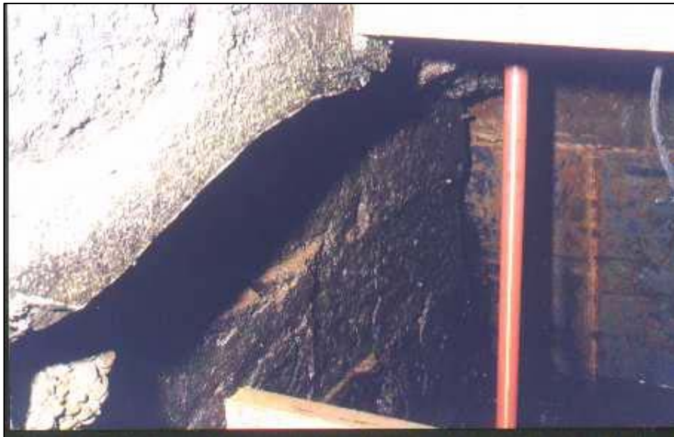
Foto 2: Vista de la falla desde el interior del dique metálico
